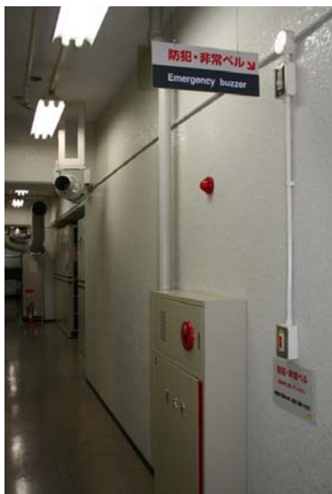
写真1 地下1階の非常ベル
