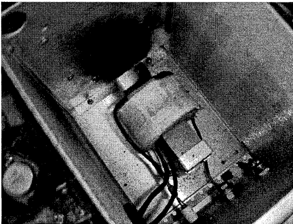
写真4a 電源ボックス内で焼けたトランス
