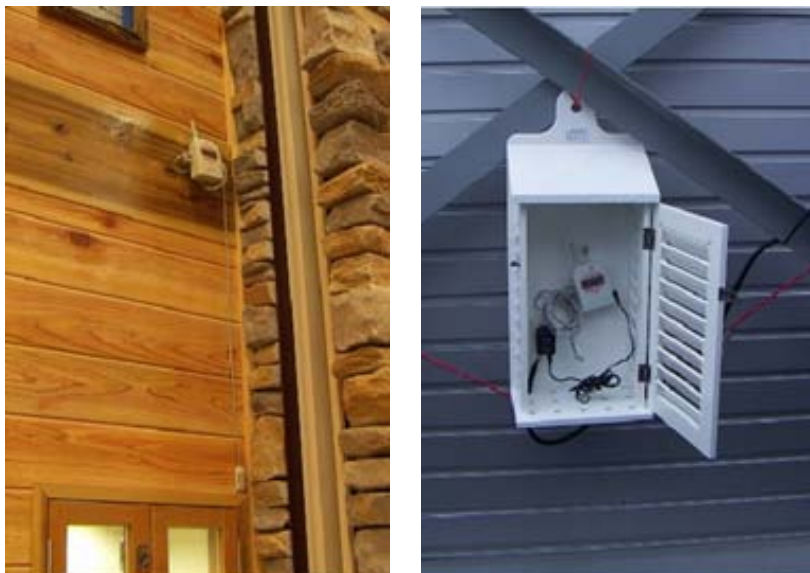
Fig. 8.4 店舗に設置された温湿度データロガー（左：室内，右：室外）
