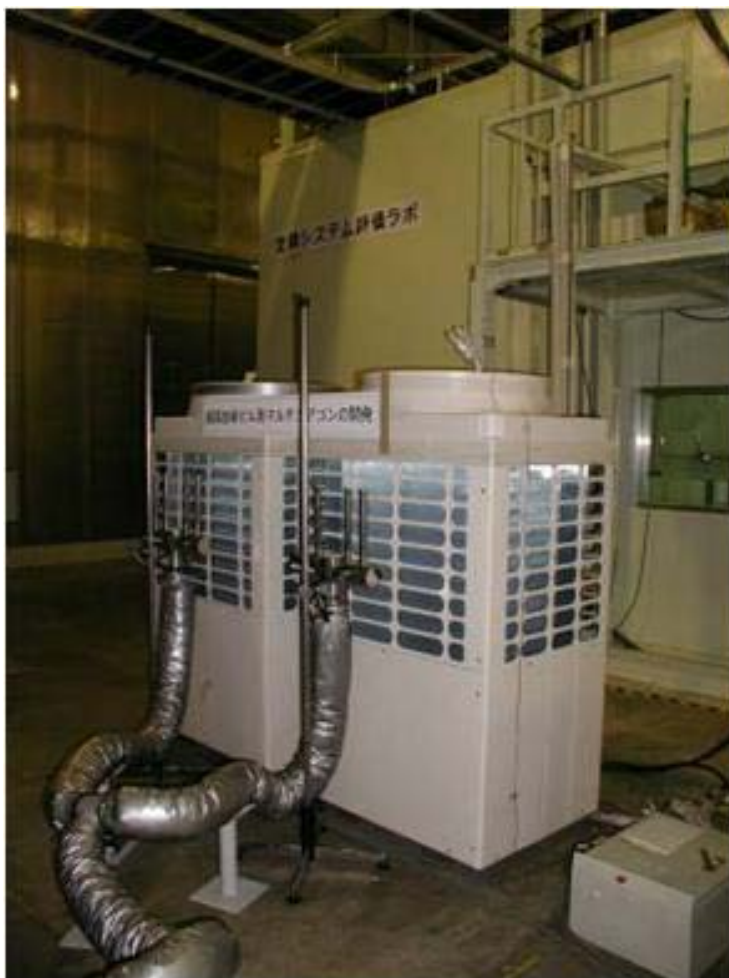
Fig. 2.3 室外側試験室におかれた室外機
