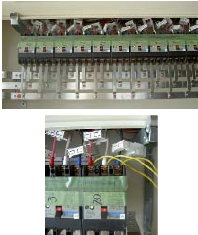
Fig. 8.3 各 EHP のブレーカーに接続された電力計
