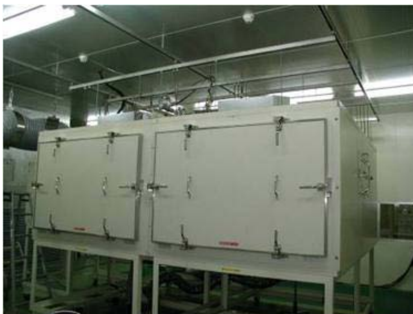
Fig. 2.5 室内機受風チャンバーの外観
