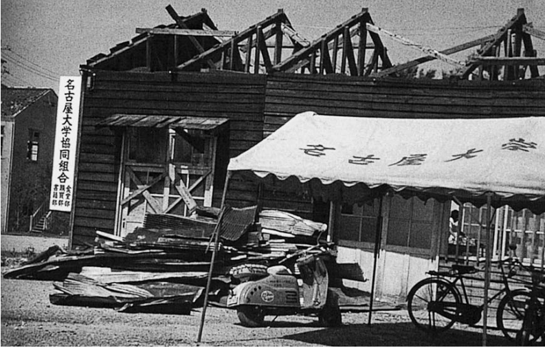
伊勢湾台風の被害を受けた建物
