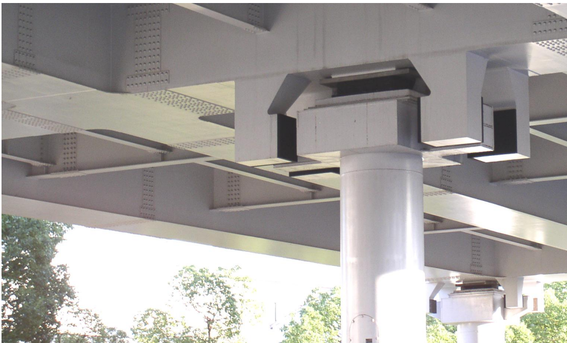
6-3; 免振構造の例 ; 上の台と柱の間に見える黒い板が免振バネである, Example of a Base Isolator, Black Plate is the Rubber Spring, Bus Terminal @ Ozone, Nagoya.
