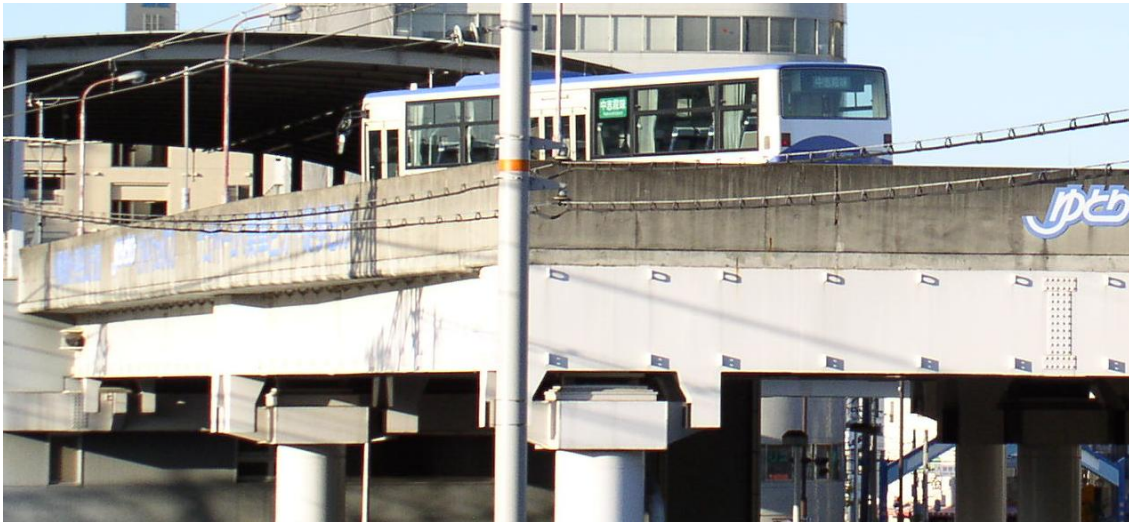
6-2; バネで支持された、重いバス・ターミナル; Example of a Base Isolator, Bus terminal sustained by Springs. Guide-way Bus Terminal @ Ozone, Nagoya.
