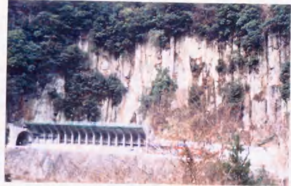
トッピング破壊 安山岩（三重県香落峡）
