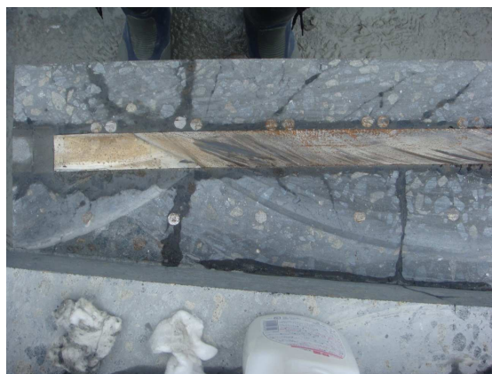
図 5- 36 主筋周辺のひび割れ例
