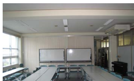
図 5-5 稼働率の高い会議室 空調機を新設し OA フロアを設置している
