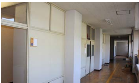
図 5-9 寮室前の廊下 廊下側の間仕切り壁は既設壁をそのまま利用
