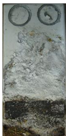
図-12 塗装膜下の腐食生成物
