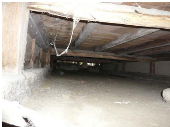
【 床下のたわみ発生部位 】
