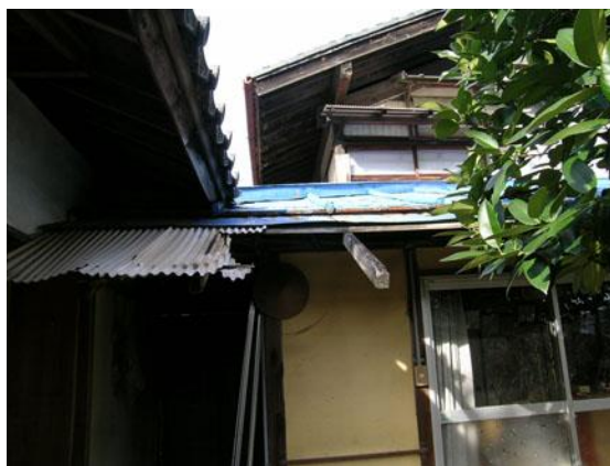
【 老朽化した鉄板屋根部 】
