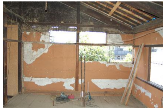
【 妻面に軒桁が廻っていない状態 】
