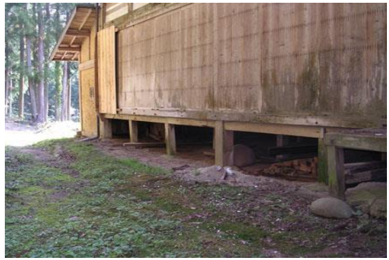
【 東立部に劣化あり】
