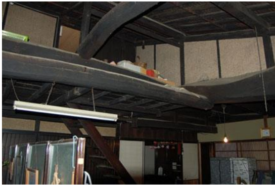
【大改修前 板の間、小屋組】 【建築時のままの丸太梁の小屋組】
