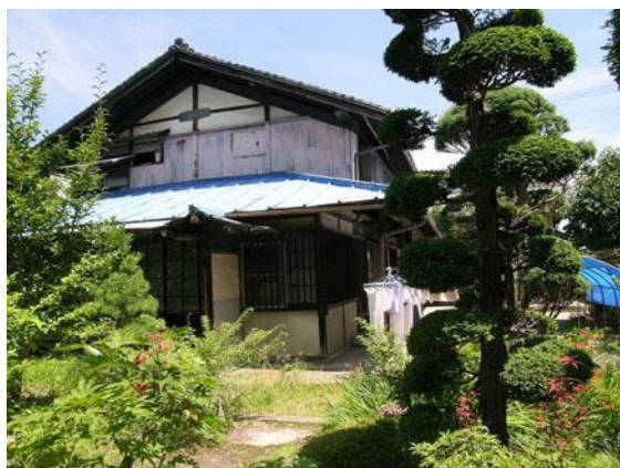
【 屋根、外壁の老朽化の進んだ南立面 】
