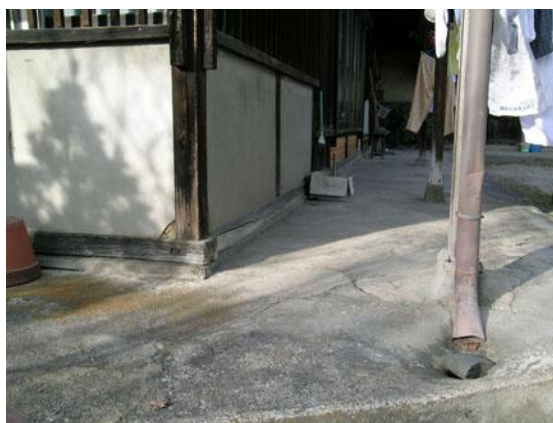
【 老朽化した土台廻り 】
