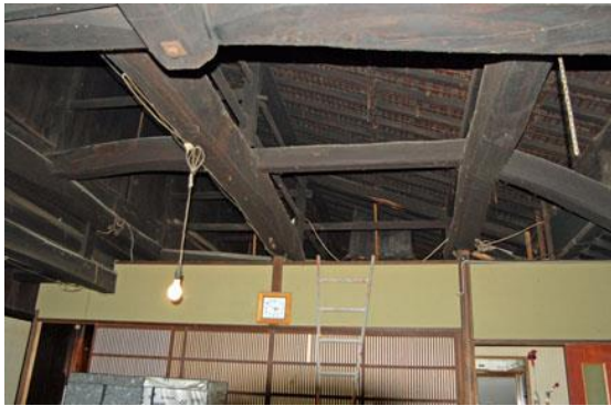
【居間改修部、間仕切りがモジュール壁と不一致】 1.
