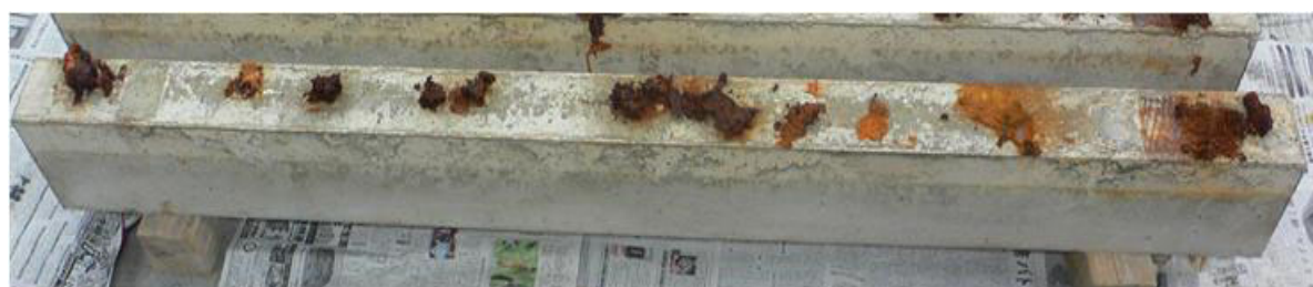
写真-1 供試体底面のひび割れからの腐食生成物の流出 (0mm-10%)
