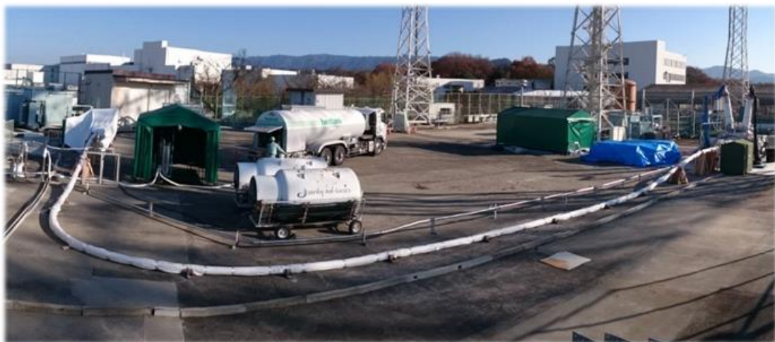
図 3.3.1-1 40m 級超電導ケーブル試験システム外観写真 (6)
