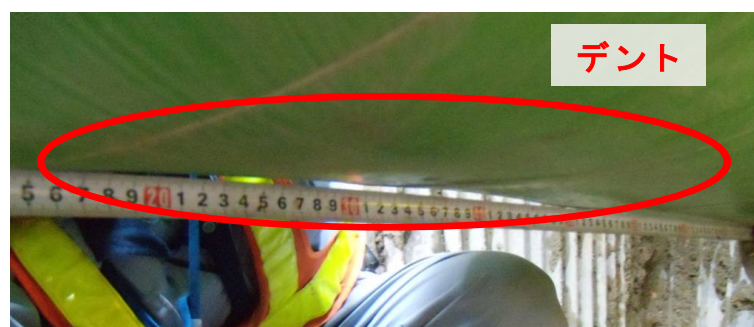
図-2.15 デントを有する鋼管（写真）
