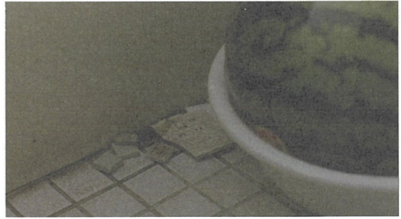
図4：両親の老化を指示する、修理されないまま放置された風呂場の壊れたタイル。
