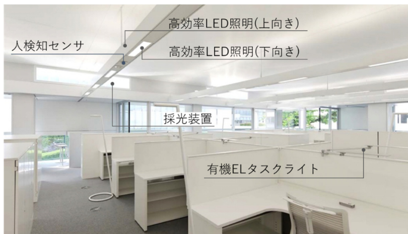
写真 2.2-2 照明システム内観写真
