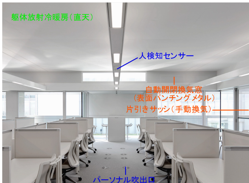
写真 2.2-1 空調システム内観写真
