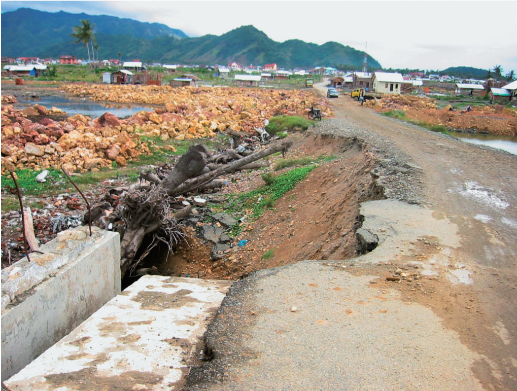
暫定復旧の道路だが本格的利用には堪えない：沿道の水没地には盛り土用の土が搬入されているが、いかにも中途半端な感がある
